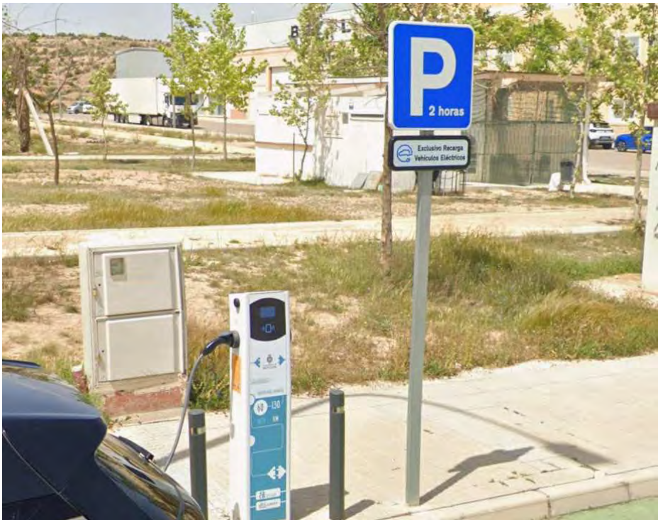
Figura 39. Plazas de estacionamiento con punto de recarga para vehículos eléctricos
